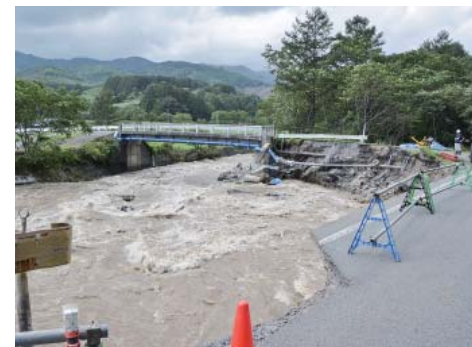
▲昨年8月の台風10号で被害を受けた道路や河川、橋、農業施設などの早期復旧に努めます（写真は町道本木遠矢場線の崩落現場）
