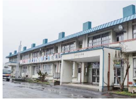
▲昭和47年に建設され、老朽化が著しい小屋瀬小学校の校舎。快適性の向上に向け、各教室の断熱工事などを実施します
