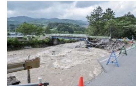
国道340号と町道本木遠矢場線が崩落。江刈簡易水道の導・配水管が破損し270世帯が断水
