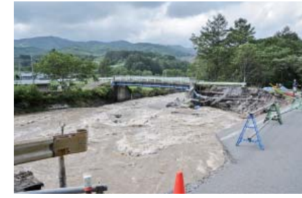
国道340号と町道本木遠矢場線が崩落。江刈簡易水道の導・配水管が破損し270世帯が断水
