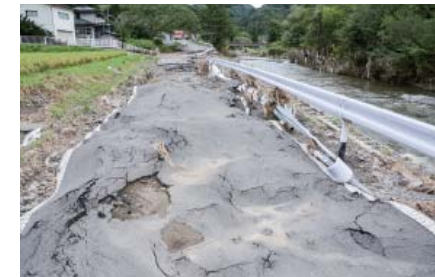
馬淵川の氾濫により路面やガードレールが破損した農道垂柳線（古川戸）
