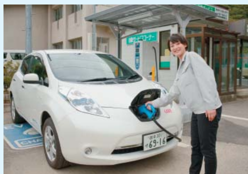
災害時などでも電気自動車への充電が可能な「防災用太陽光発電急速充電器」の整備を進めます（写真は役場前の充電設備）
