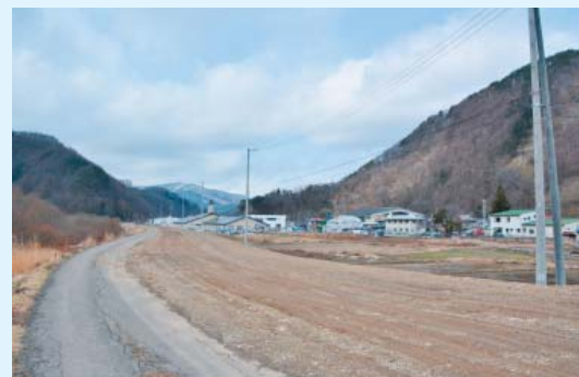
早期完成を目指し、改良工事が進められている町道茶屋場田子線（写真は田の沢地区）
