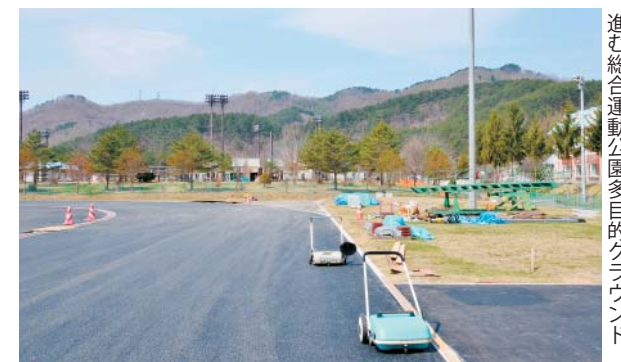
6月20日の完成に向けて順調に工事が進む総合運動公園多目的グラウンド
