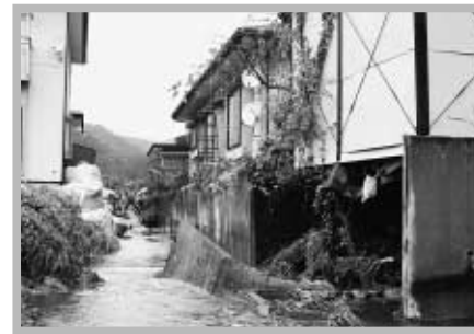
家と家との間を水が走り、土台の土がえぐられ建物の擁壁が崩落（8日午前10時＝元町）
