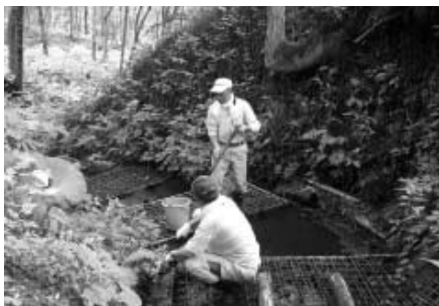
平庭高原に設置した水質浄化装置の保守管理 (金網カゴ1基の木炭量は128kg)
