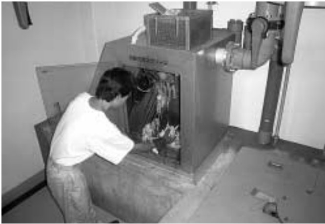
配水管から汚水処理施設に流れてきた異物の除去作業 (四日市クリーンセンター)
