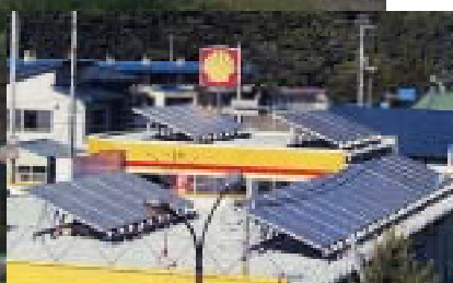
太陽光発電（鈴木商店） 8.75キロワット、平成13年設置
