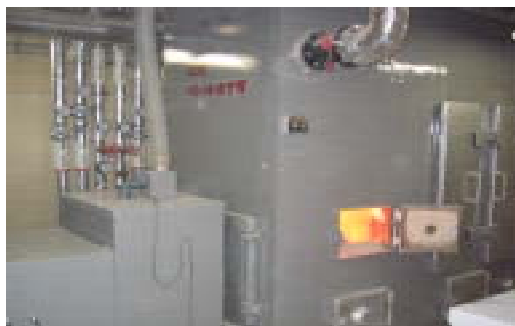
ペレットボイラー（アットホームくずまき） 1時間当たり500,000キロカロリー×2基、 平成15年整備
