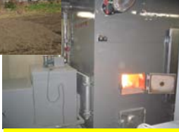
⑥ペレットボイラー H15 50万kcal × 2 太陽光発電 20kW @アットホームくずまき
