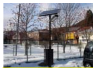
⑬太陽光街灯 100W H19 @街なか駐車場
