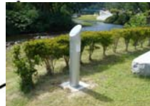
⑮太陽光誘導灯 H20 16.24W (2.03W × 8基) @小田農村公園
