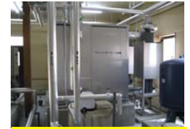
⑭ペレットボイラー 50kW × 2 H20 @森のこだま館
