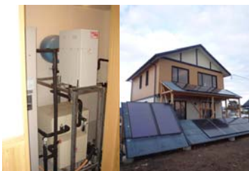
⑯ゼロエネルギー住宅 H19 地中熱ヒートポンプ 9.5~10.5kW 太陽光発電 3.36kW 太陽熱温水器 2.87㎡ @くずまき高原牧場
