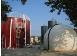
③畜ふんバイオマスシステム 37kW H15 @くずまき高原牧場
