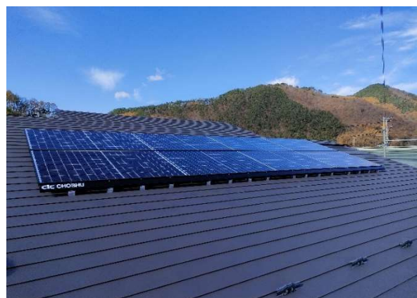
エコ・エネ総合対策事業で導入した太陽光発電設備
