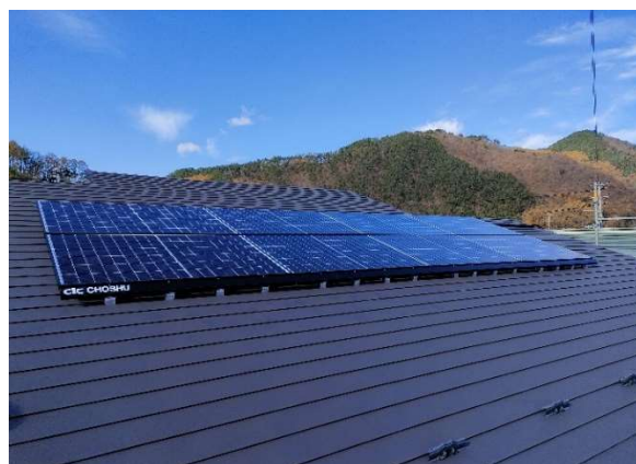
エコ・エネ総合対策事業で導入した太陽光発電設備
