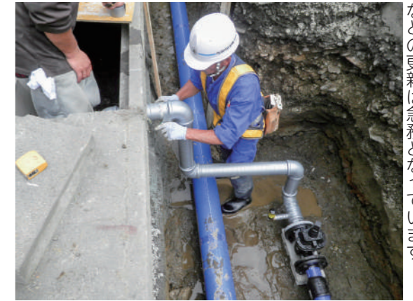
安定した水道を維持するために水道管 などの更新は急務となっています
