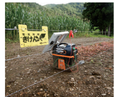
農地に設置された電気柵
