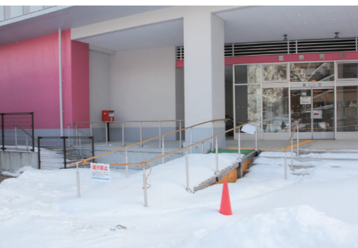
ロープで囲われた「通行禁止」の病院玄関前通路
