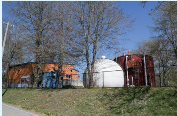
くずまき高原牧場のバイオガスプラント
