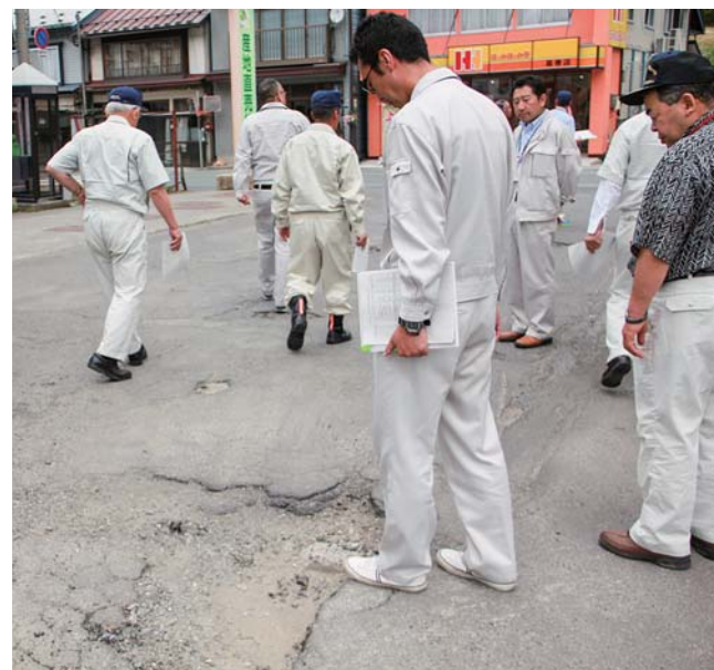
路面の破損が進んでいるJR葛巻駅構内
