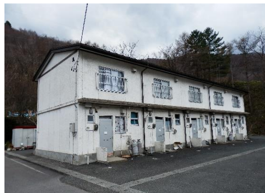
経年劣化が進む町営住宅
