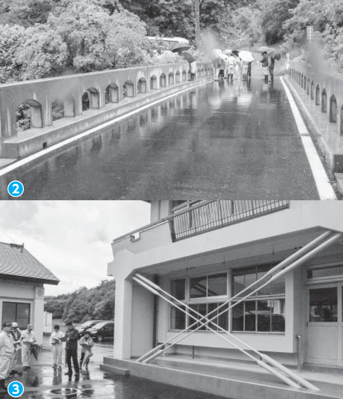
① 林道案内沢線の法面の崩落箇所 ② 補修工を終えた青刈橋（一戸町境） ③ 耐震補強工事で筋かいを設置（小屋瀬小学校）
