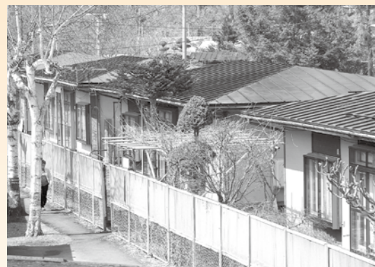
老朽化が進む医師住宅
